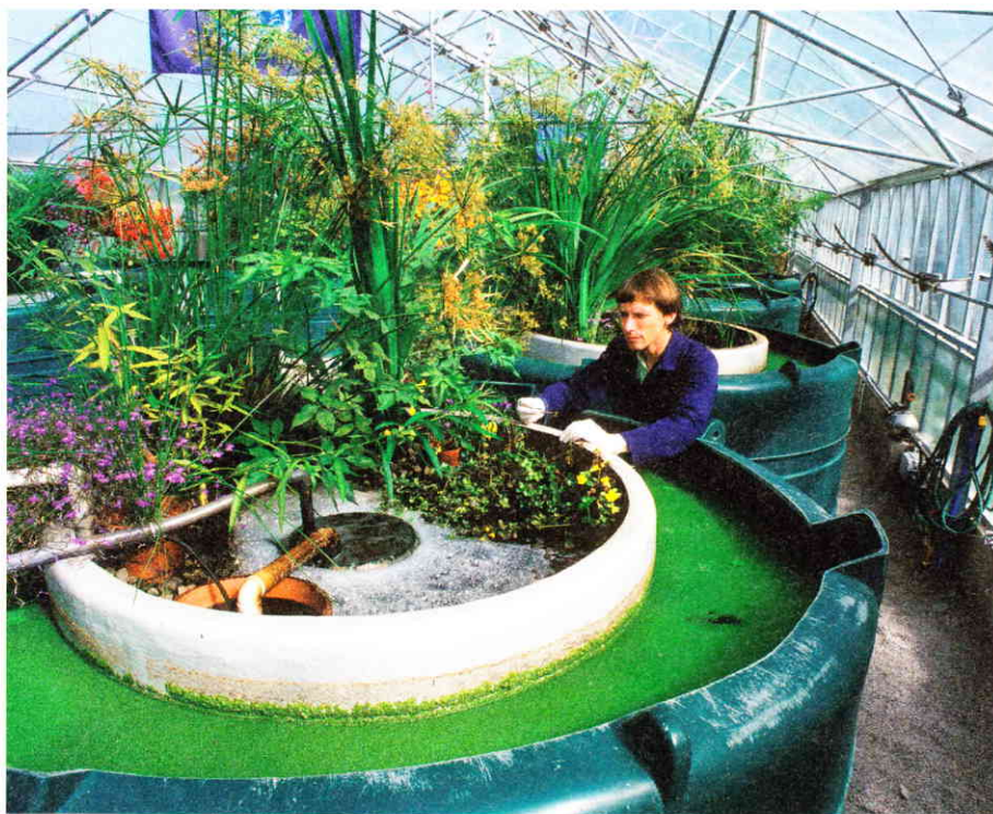
IN HET SCHOTSE ECO-DORP FINDHORN WORDT HET AFVALWATER VAN DE GEMEENSCHAP GEZUIVERD DOOR HET IN VERSCHILLENDE TANKS TE BEHANDELEN.
